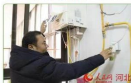
河北省推进农村地区冬季清洁取暖全覆盖。图为晋州市经济开发区的居民在家中天然气壁挂炉
